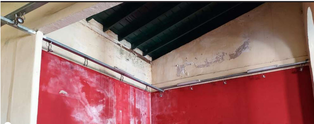
LA GALERÍA presenta múltiples Filtraciones
