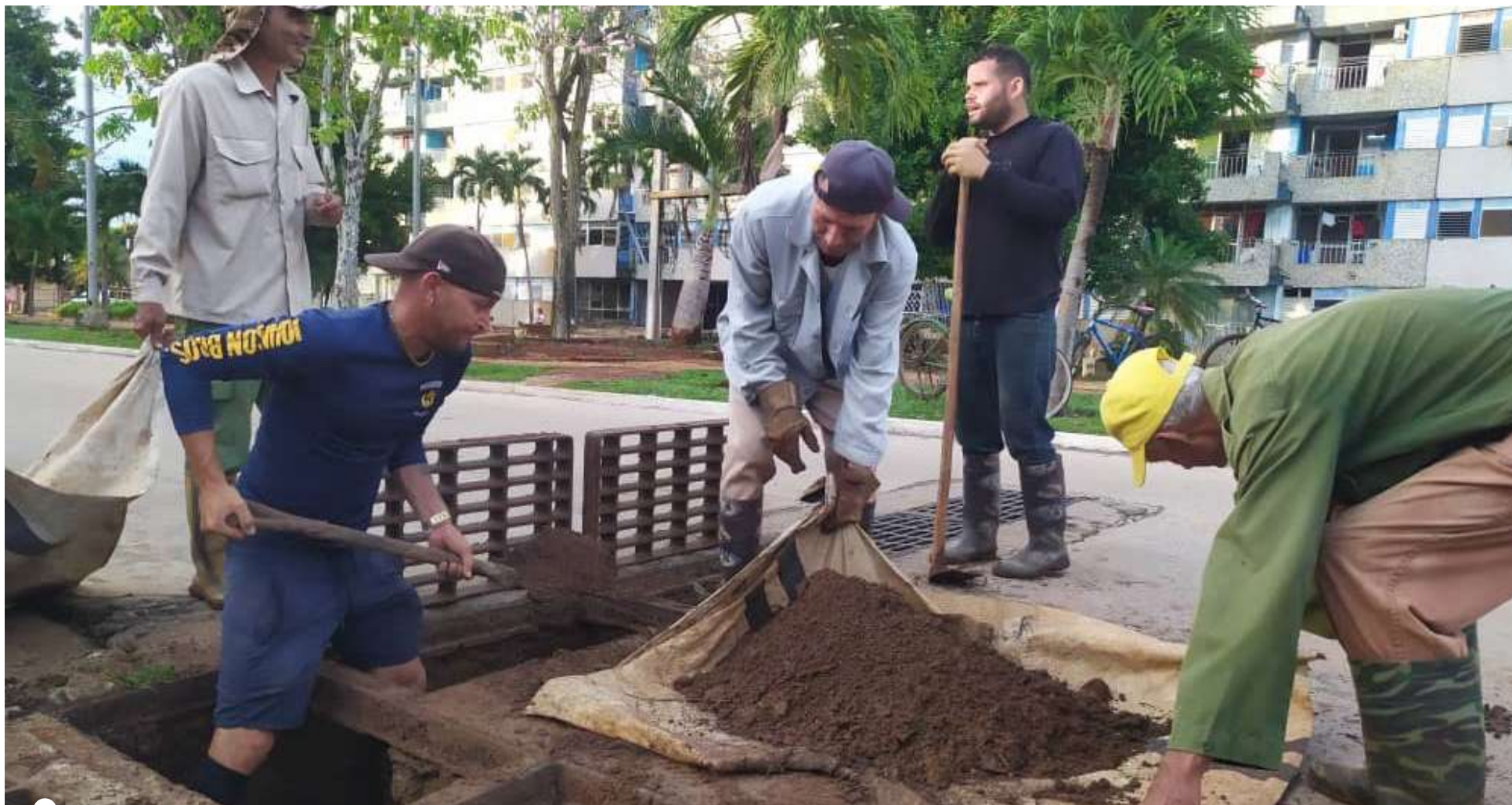
ACCIONES DE LIMPIEZA y desobstrucción de alcantarillas forman parte de los ejercicios preventivos dada la cercanía de la temporada ciclónica
